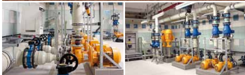
Oben: Betriebsgebäude des Zweckverbandes Wasserversorgung Trollmühle; unten links: Pumpengruppe zur Wasserenthärtung; unten rechts: Regenerier- und Bypass-Pumpen
