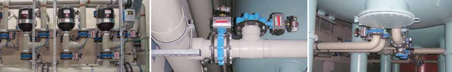
v. l. n. r.: Rohwasserfilteranlage; Abzweig-Bypass; Auslauf- und Regenerier-Leitung
