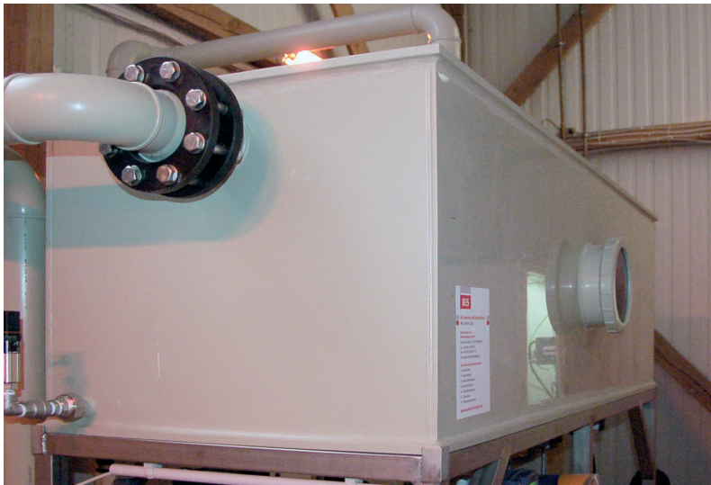
Entsäuerungsanlage, gefertigt aus PP-Plattenmaterial, Stärke: 15 mm
