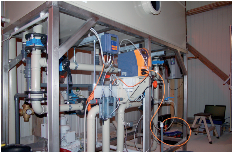
Zuschaltbare Dosiereinrichtung für Natriumhypochlorit
