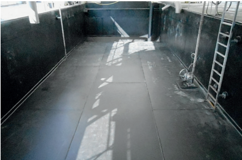
Ungereinigter Endzustand nach der Sanierung mittels PE-Auskleidung
