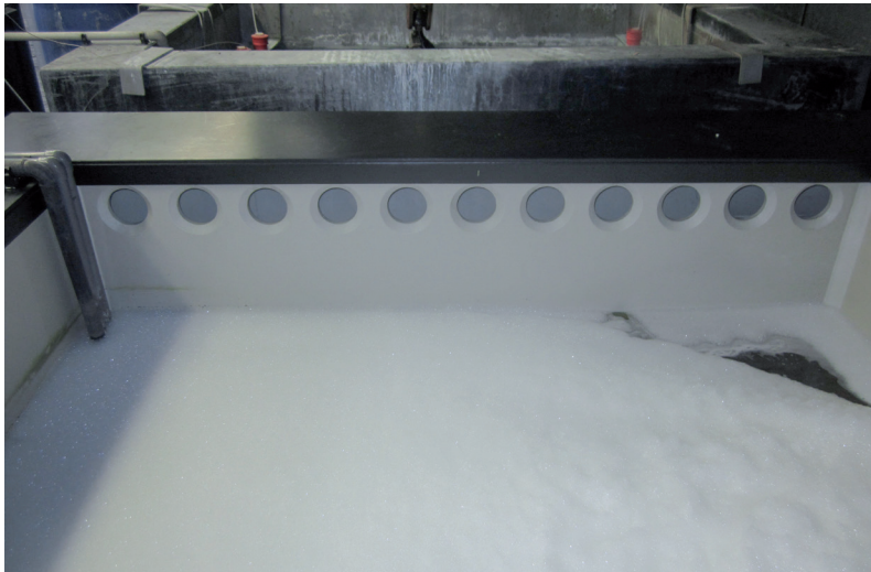
Königswasserbehälter mit PE-Verschleißschutz - installiert und im Betrieb
