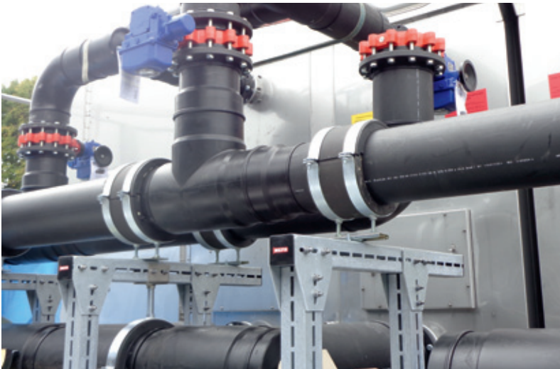
Anschluss der Kühltürme am Dach des Gebäudes
